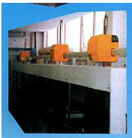
Chaîne de nettoyage automatique équipée de robot sans fil
